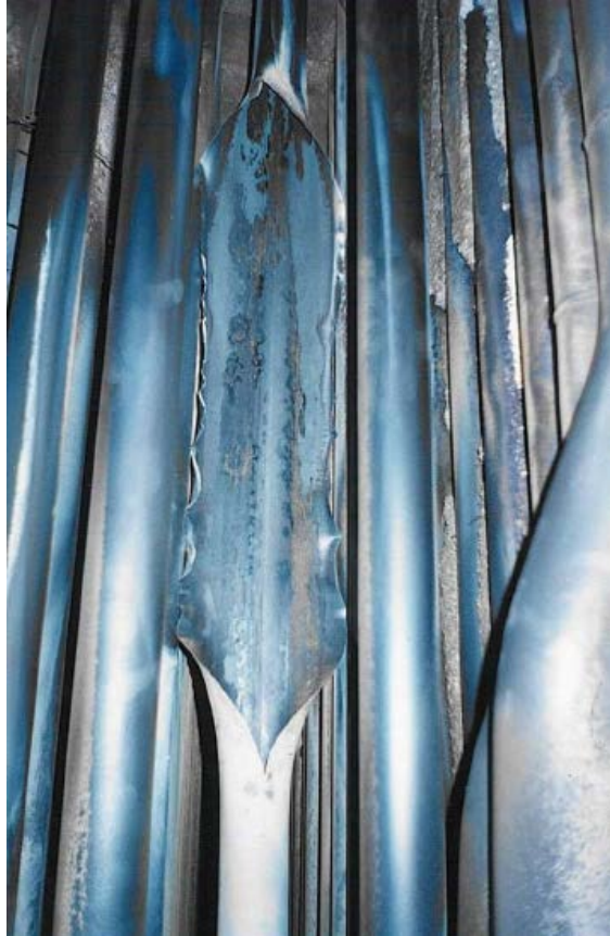
Desgaste nos tubos de caldeira
