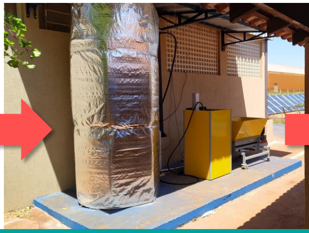
Reservatório Térmico (4000L)
