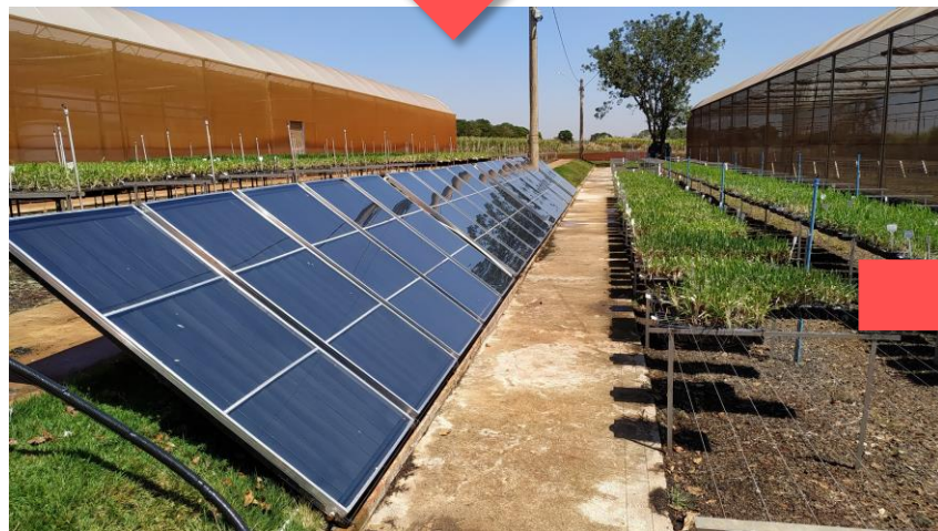
40 m 2 de Placas Solares
