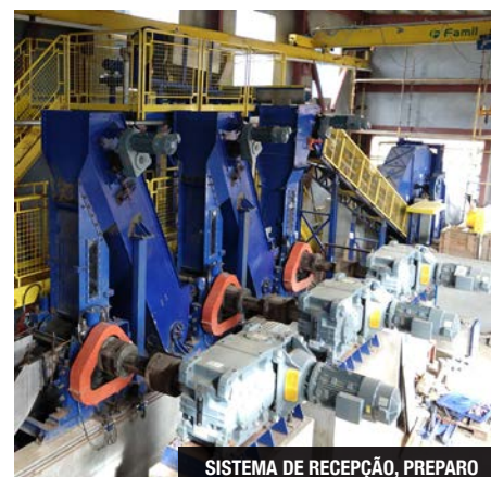
SISTEMA DE RECEPÇÃO, PREPARO E EXTRAÇÃO PARA CANA
