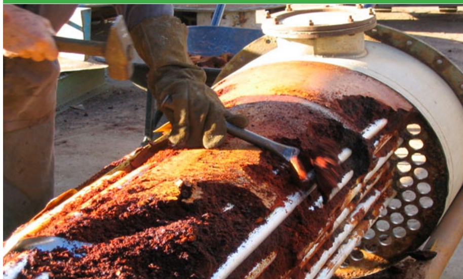
FIGURA 1. ACÚMULO DE RESINA
