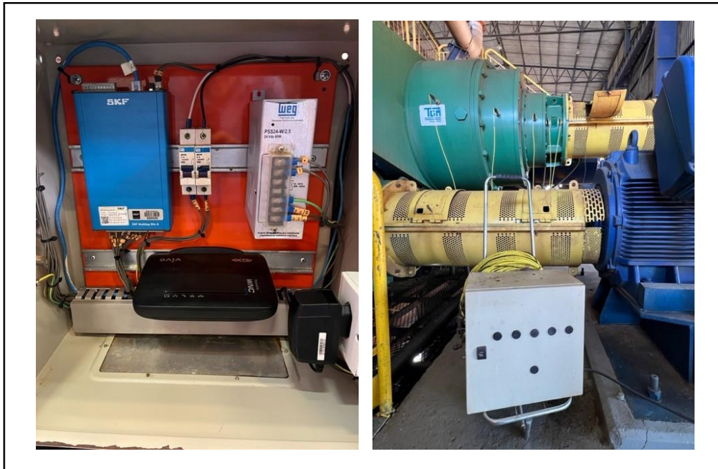
Instalação do Sensor IMX8 nos planetários da moenda.
