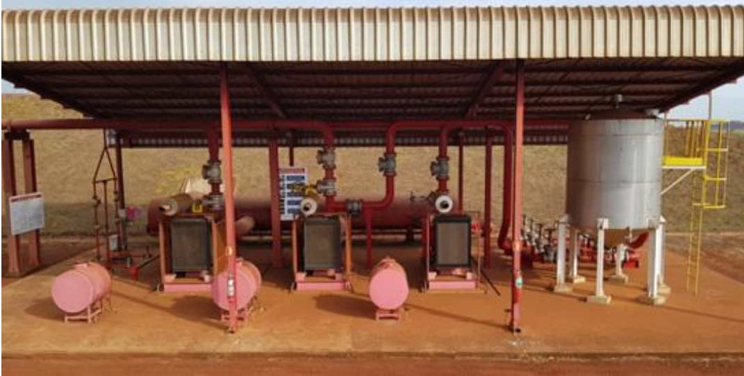
Casa de Bombas 3 x 800m 3 /h x 13 kgf/cm 2 - S.P.C.I.
