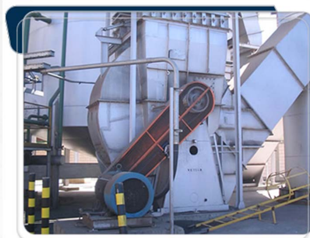
Análises de Performance de Ventiladores/Exaustores
