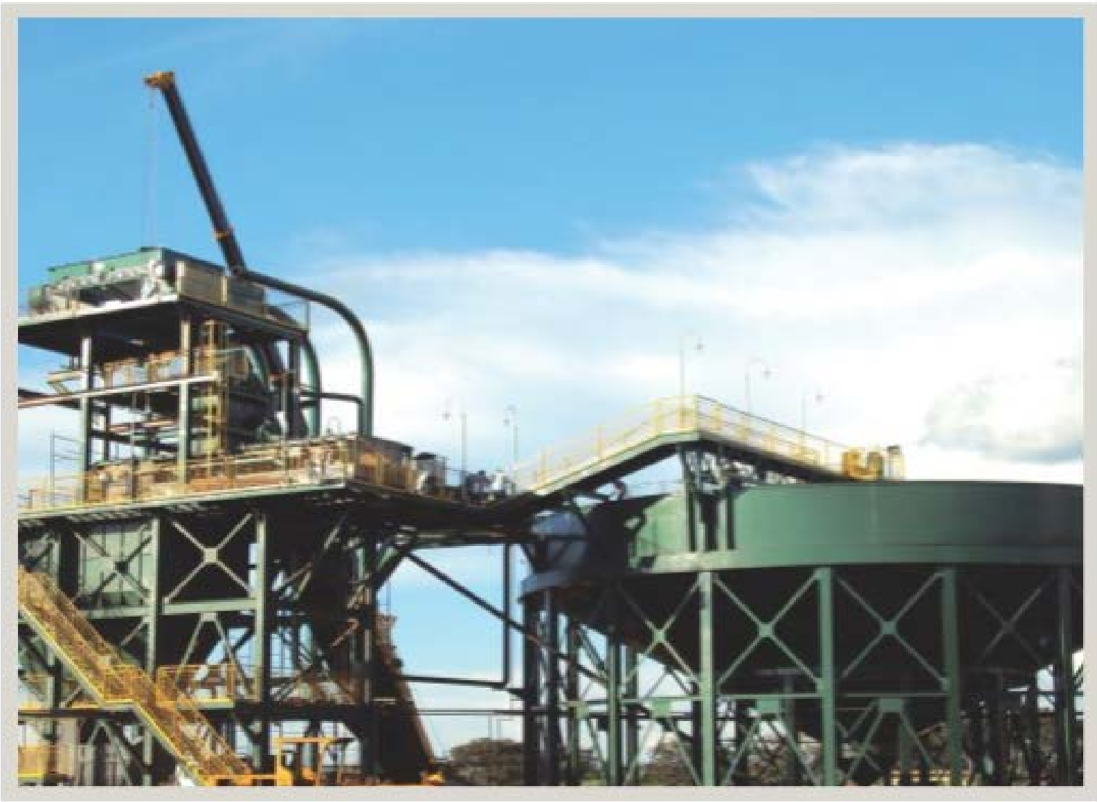
SISTEMAS DE TRATAMIENTO DE AGUA / DECANTADOR DE FULIGEM
