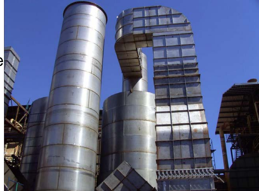
Lavador de gases instalado na Usina Alta Mogiana
